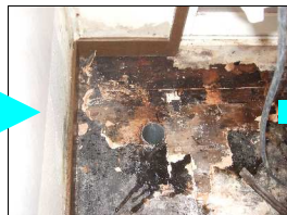
洗濯機の下の下地の一部が腐っていた
