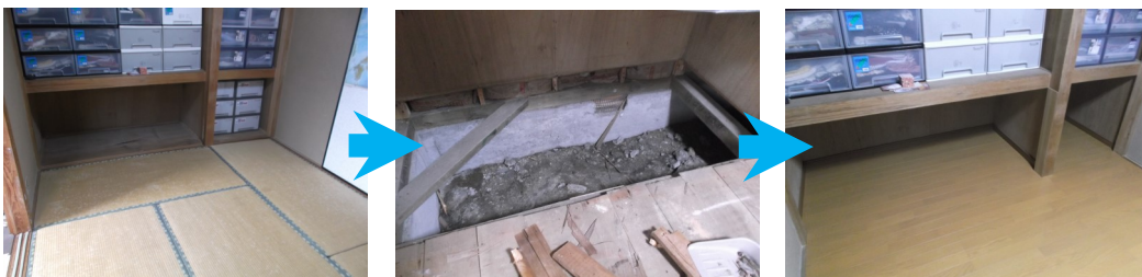
畳を処分して下地を補強しながら、衣装ケースを出し入れしやすいように、敷居を取り除きました。
